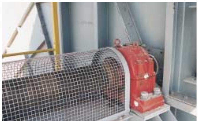
Unidad motriz de un ventilador
