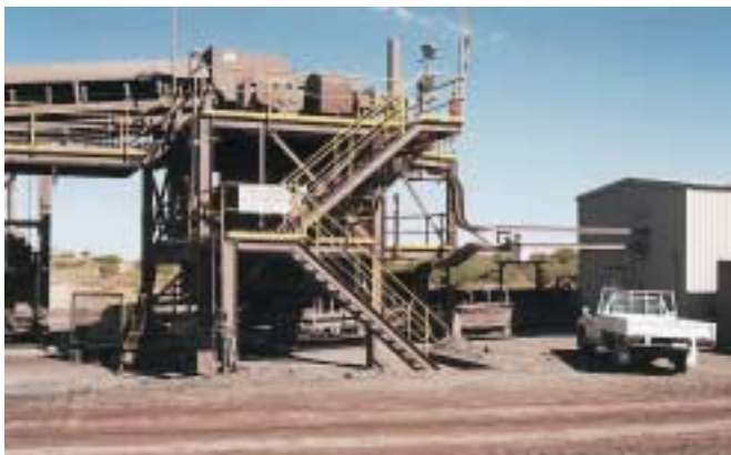
Unidad motriz de una planta transportadora
